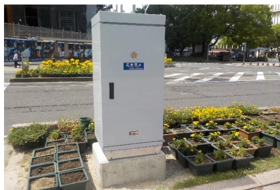
【自動起動式信号機電源付加装置】
