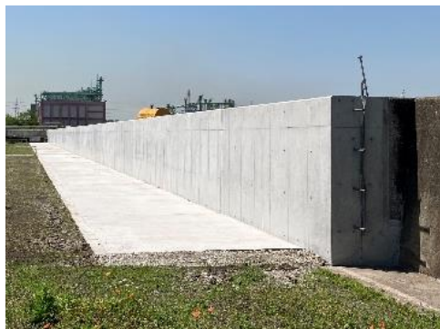
【防潮壁の地震・津波対策（昭和心頭地区）】
