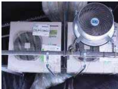
今年の冬から稼働予定の ヒートポンプ
