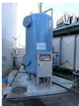
高性能な井水浄化装置
