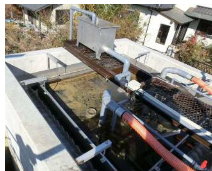
増設した汚水処理施設
