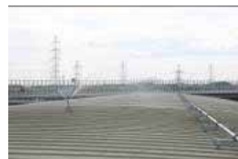
市場棟屋上の散水装置
