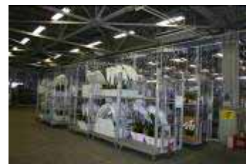
卸売場の洋らん用定温庫
