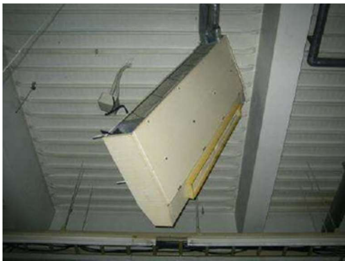
吊りボルトの破断例
