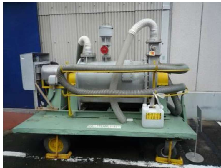
ガス吸収装置
