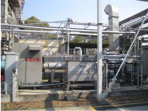
EOタンク排ガス除害装置 (触媒燃焼式)
