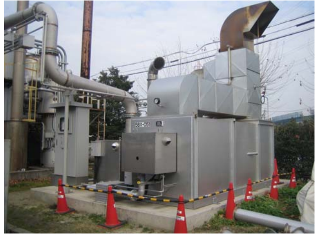
有機合成プラント直燃式VOC処理装置
