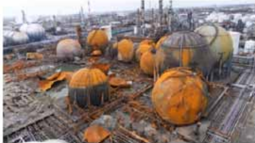
鎮火後の発電施設
