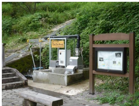
農業用水を利用した小水力発電施設(新城市)
