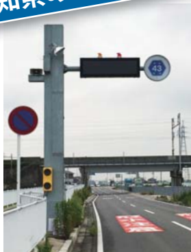
情報板の設置
