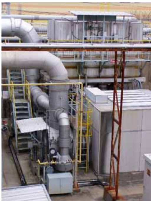
写真1. 蓄熱式燃焼設備の外観
