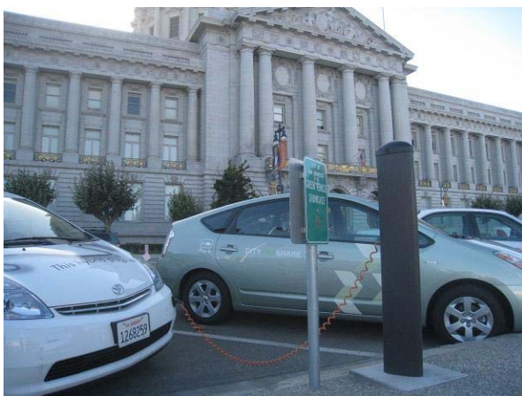
サンフランシスコ市役所前に設置された充電設備
