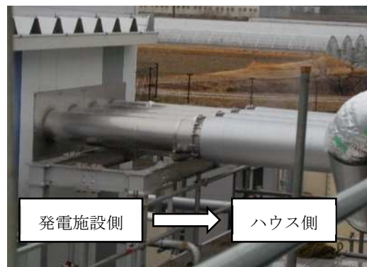
発電施設からの熱・CO 2 配管
