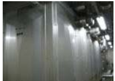
ムーアカデミーの地下にある蓄熱槽
