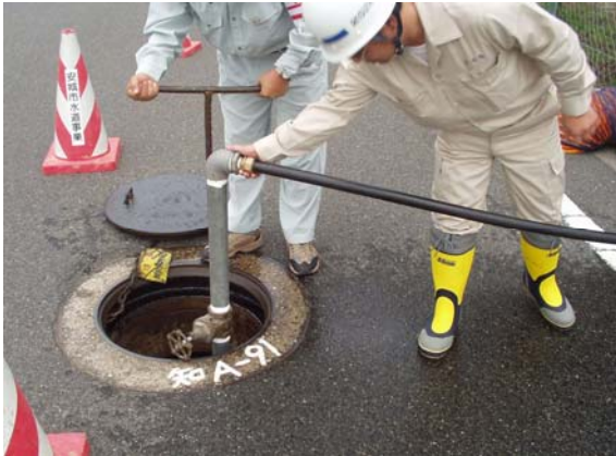
写真1 応急給水支援設備操作状況
