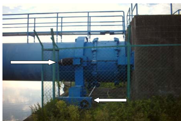
落橋防止装置の設置事例(筏川第2水管橋)
