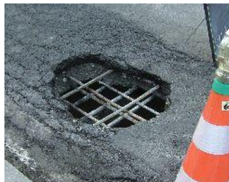
写真 3.1.2 床版の抜け落ち
