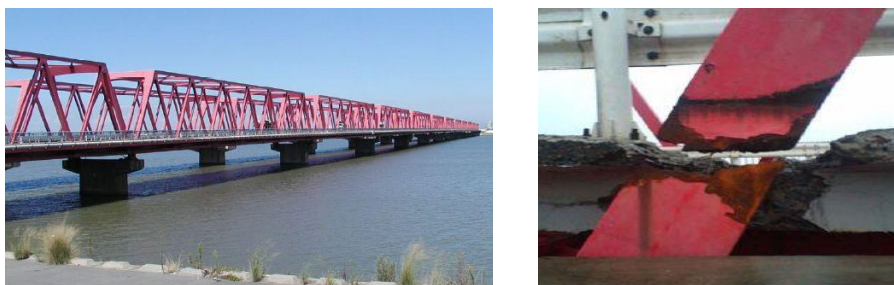
写真 1.1.1 木曾川大橋のトラス斜材の破断事故
