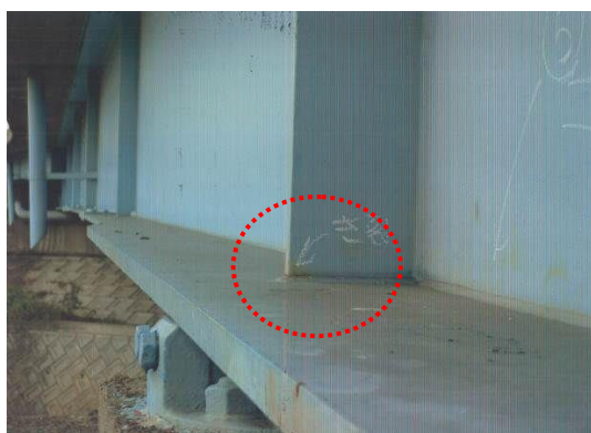
写真 4.3.1 垂直補剛材部の損傷
