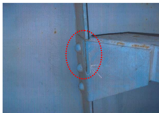
写真 4.3.2 横構取り付け部の損傷
