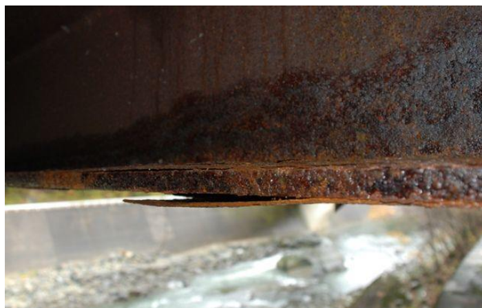
写真 4.5.1 耐候性鋼材の腐食（桁端付近の層状さび）
