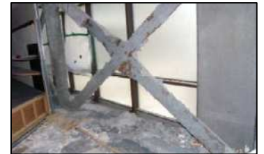
【地震により囲い込みが破損、アスベストが露出した例】
