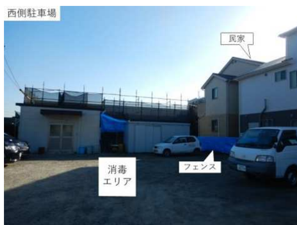
写真5 消毒液の飛散防止措置
