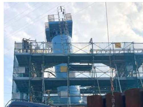
施工中のケーソン基礎の傾斜(R5年9月28日発生)
