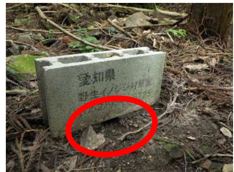
ブロックの下側が掘られていた様子
