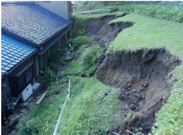
新城市（被災状況）
