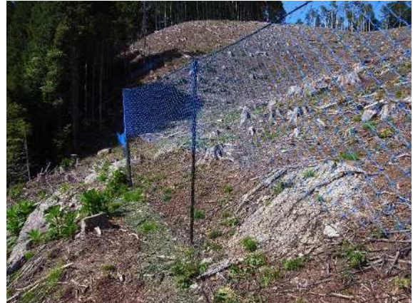
獣害防止柵設置（豊田市坪崎町 地内） 柵は高さ1.8m, 下部1mはステンレス入ネット
