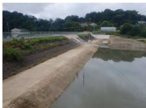
耐震のための堤体押さえ盛土 (防災ダム事業 八木池上池・下池地区 下池 池の内側)
