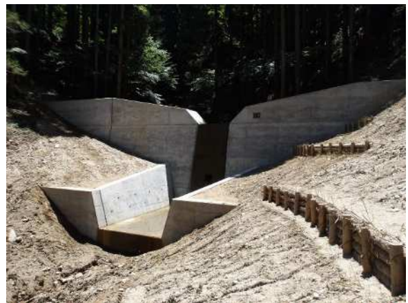
荒廃溪流に設置した治山ダム
