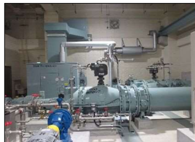
菱池排水機場（ポンプ設備）
