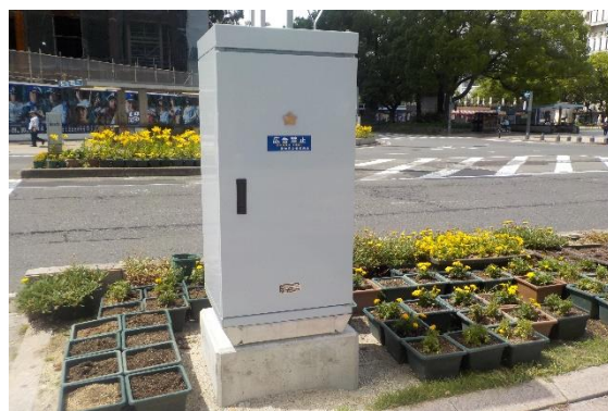
【自動起動式信号機電源付加装置】
