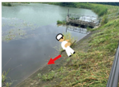
(ため池堤体の急傾斜)
