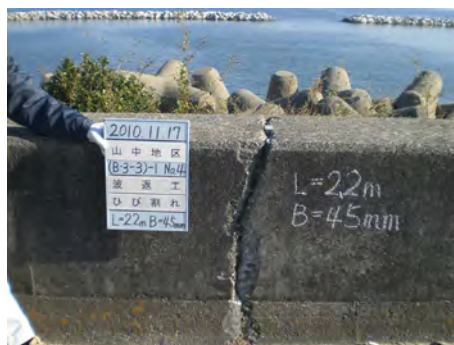
波返し工ひび割れ (三重県鈴鹿市)
