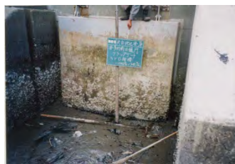
ヘドロの堆積 (フラップゲート)
