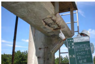
破損 (スライドゲート)
