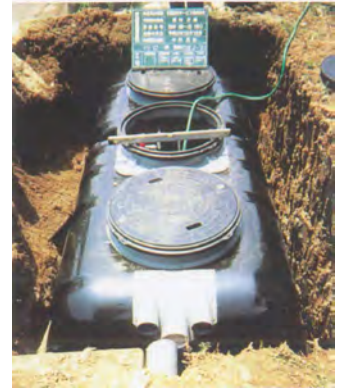
合併処理浄化槽
