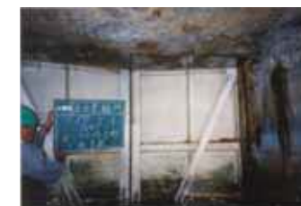
水漏れ（マイターゲート） 資料：三重県
