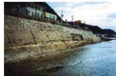
老朽化している海岸堤防（愛知県南知多町）
