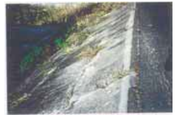
堤防の劣化（三重県河芸町）
