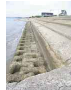
老朽化している海岸堤防（愛知県美浜町）
