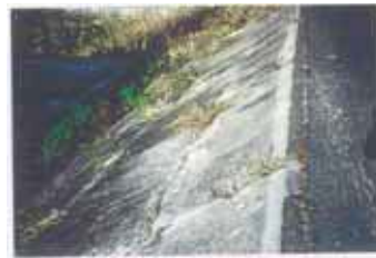
堤防の劣化（三重県河芸町）
