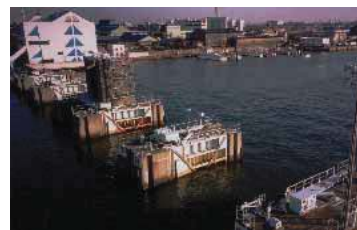
老朽化した水門
