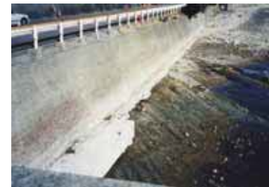
洗掘された海岸堤防（愛知県南知多町）
