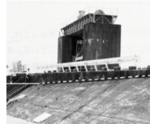
深い基礎を持つ水門と堤防の不等沈下（三重県木曾岬町）
