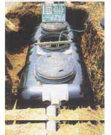
合併処理浄化槽 資料：生活排水処理施設整備計画 (三重県)
