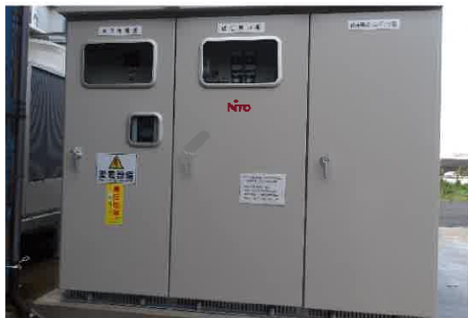
受変電設備（常滑市）
