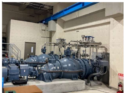
新田排水機場（ポンプ設備）
