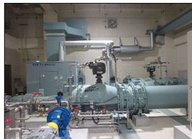
菱池排水機場（ポンプ設備）
