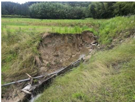
農地の法面崩壊（幸田町）
