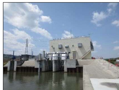
菱池排水機場（全景）
