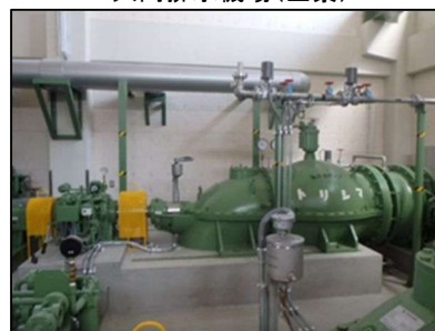
大岡排水機場(ポンプ施設)
