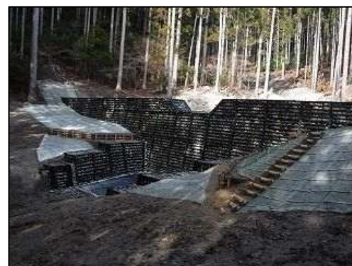
谷止工（鋼製自在枠）（岡崎市）
