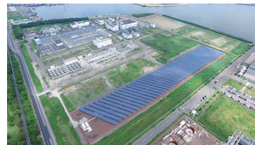
水処理施設への太陽光発電施設設置例 (衣浦西部浄化センター)
