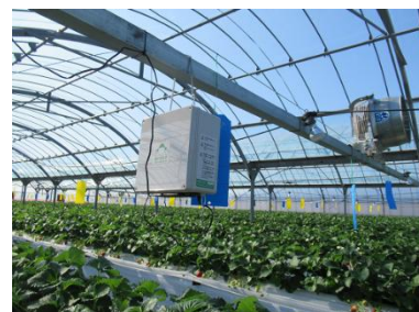
環境測定装置の設置状況
