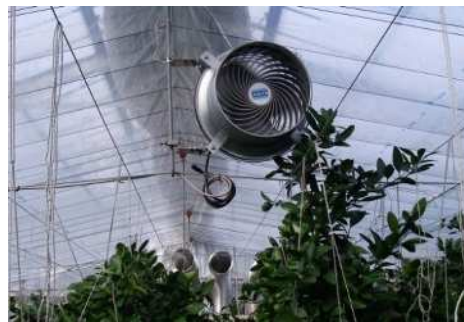
写真 ハウスみかん施設に導入された被覆(内張)の多層化及び循環扇
