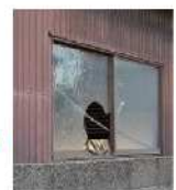
窓が割れた 管理不全空家
