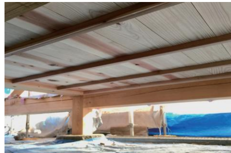
写真 3-8 断熱材が露出しないような対策を講じた開放的な床下
