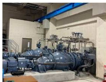
前野排水機場（ポンプ設備）
