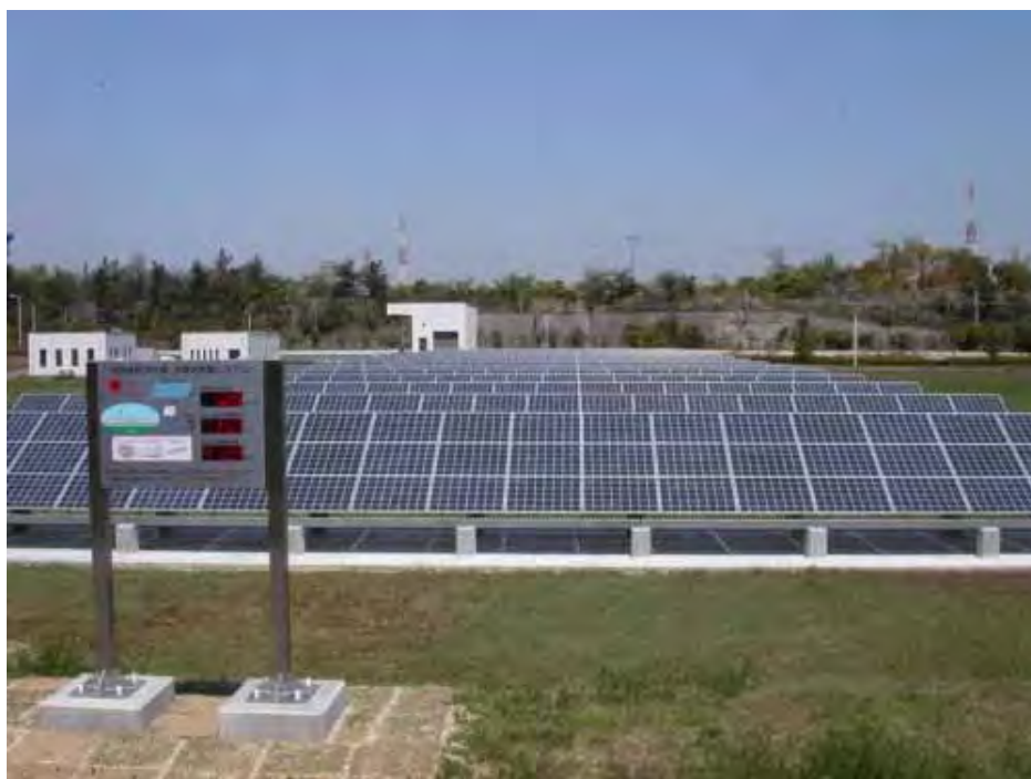
図 - 9 太陽光発電設備（愛知県尾張東部浄水場）
