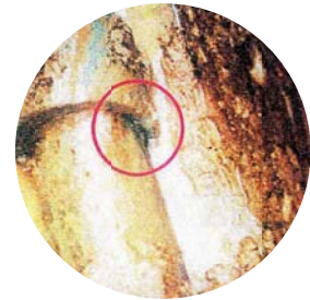
カラー継手部より漏水
