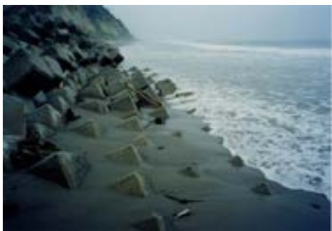
豊橋海岸西赤沢の侵食状況(H13.12)
