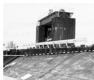
深い基礎を持つ水門と堤防の不等沈下 （愛知県と三重県の県境）
