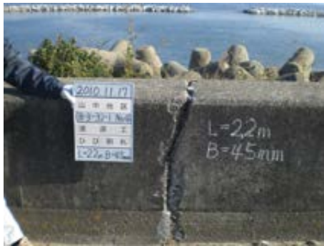
波返し工ひび割れ (三重県鈴鹿市)
