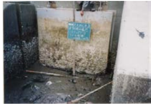
ヘドロの堆積 (フラップゲート)
