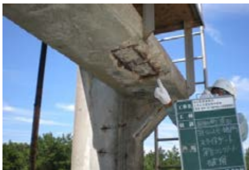
破損 (スライドゲート)
