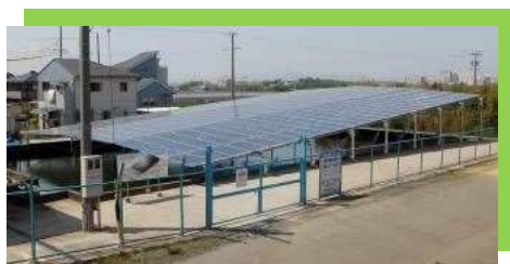
【農業用施設を利用した太陽光発電】
