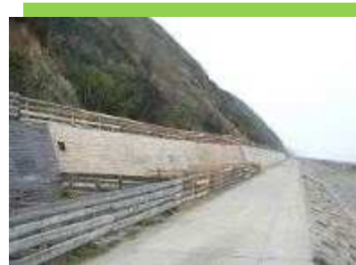
【表浜海岸の防風・防潮対策のための施設】
