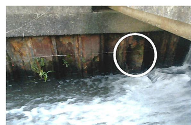
欠損箇所（榎津・江松排水路）
