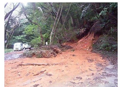
山腹斜面崩落
