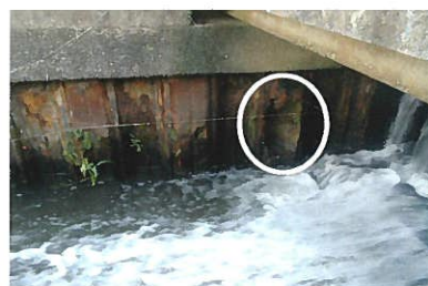
欠損箇所(榎津・江松排水路)
