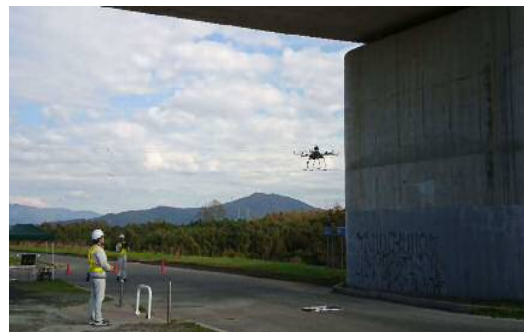
無人飛行ロボットによる橋梁点検の民間実証実験 ((主)東三河環状線(豊川市):三上橋)
