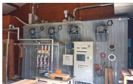
図 2.3. 人工乾燥の例(蒸気式)
