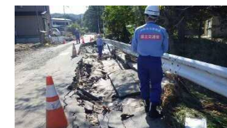
台風第19号におけるTEC-FORCEによる道路被災状況調査
