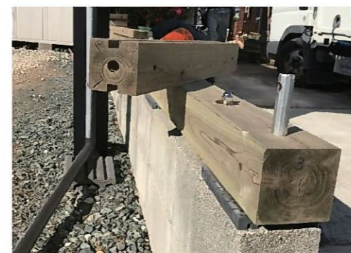
従来はホゾ瘦せによる揺らぎがあった。 今回ホゾ金物の利用により揺らぎが無くなる。 土台パッキンにより土台を保護。
