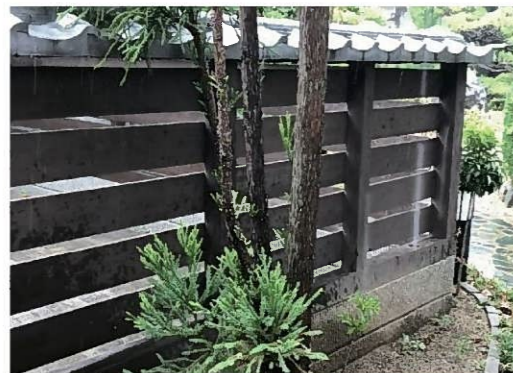
築20年A様邸(防腐+塗装) 塗装の落ちが見られるが木材の劣化は無い。
