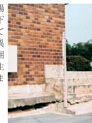
地盤沈下の状況
